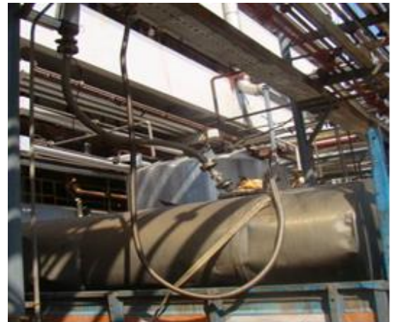
槽罐车进料排空平衡装置
